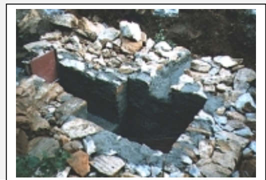
Figura 10-16 El flujo del agua hacia la cámara de carga es controlado por una compuerta. Se ha hecho una canaleta de rebose en la pared de cuesta abajo para que el agua sobrante se retorne al arroyo sin socavar la mampostería. Un tubo de drenaje y limpieza, sellado con un tapón de madera, ha sido incorporado en la parte más baja del fondo del tanque.
