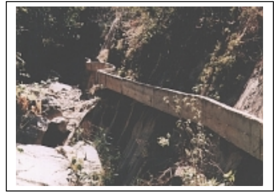
Figura 10-6 Un canal instalado sobre terreno difícil abastece a una pequeña planta hidroeléctrica (Peru)
