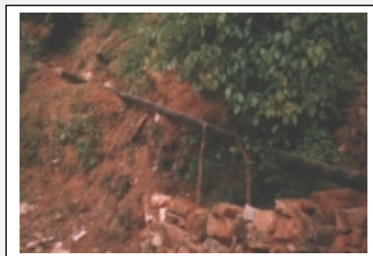
Figura 11-5 Tramos de tuberías que cruzan hondonadas en el terreno, tienen que estar apoyados a la elevación correcta.
