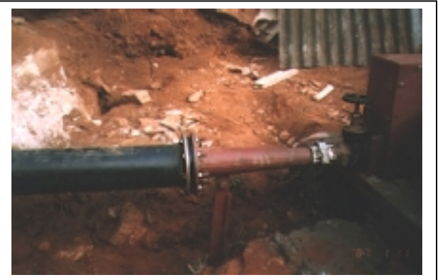
Figura 11-10 Unión de tubería forzada con flanges
