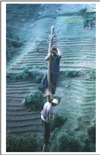
Figure 14-1 Instalación de un sistema de distribución para una aldea (Kushadevi, Nepal)
