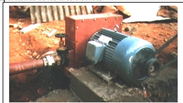
Figura 8-3 Un Pico Power Pack instalado
